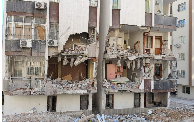
Şekil 27. Yıkılan bir binanın komşu binada hasara neden olması
