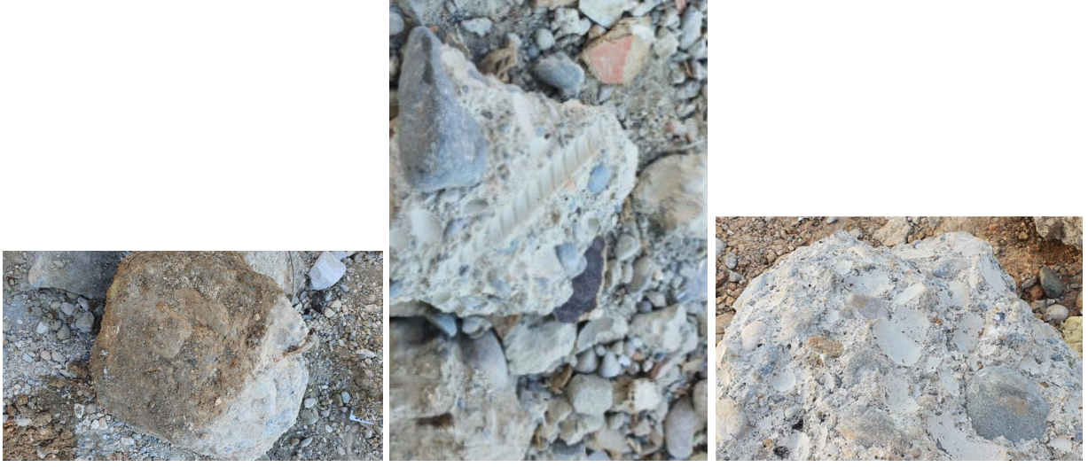
Şekil 28. Betonda çok iri agrega kullanımı
