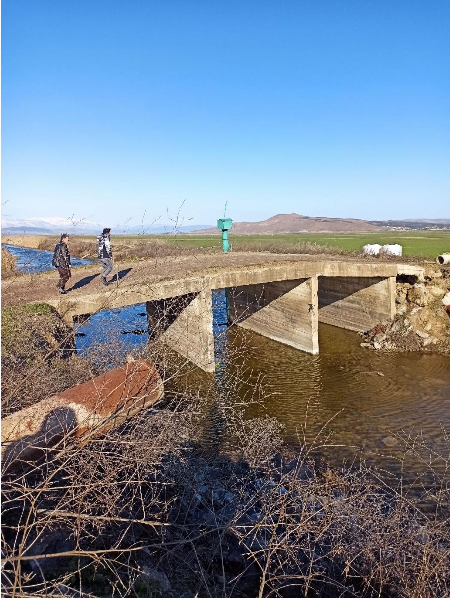
Şekil 36. Beyođlu, Yeni Mahalle civarında (Kahramanmaraş) DAF zonu üzerinde yaklaşık Dere üzerindeki köprü kenarında köprünün bentleşmesi nedeniyle güneydođu kesimde meydana gelen kırılma.
