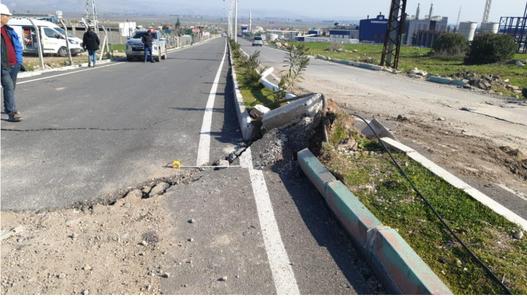
Şekil 27. Beyazıdi Bestami Türbesi karayolu üzerinde (Kırıkhan/Hatay) 45 cm sol yanıl doğrultu atımın oluřtuđu alan.
