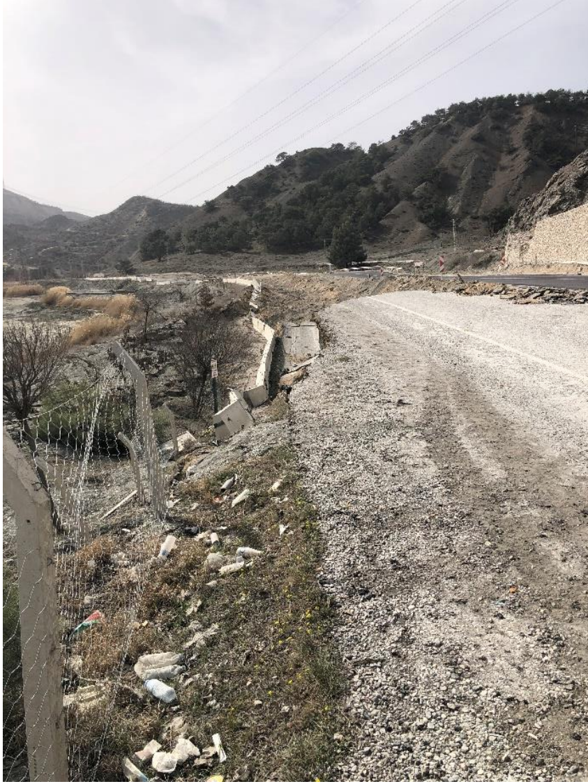
Şekil 38. Nurhak Karayolu üzerinde deprem sırasında meydana gelen zemin sıvılaşması ile gelişen yanal yayılma ve dairesel kayma türünde yenilmeler karayolu boyunca mevcut şevlik kesimlerdeki mühendislik yapılarına önemli ölçüde zarar vermiştir.
