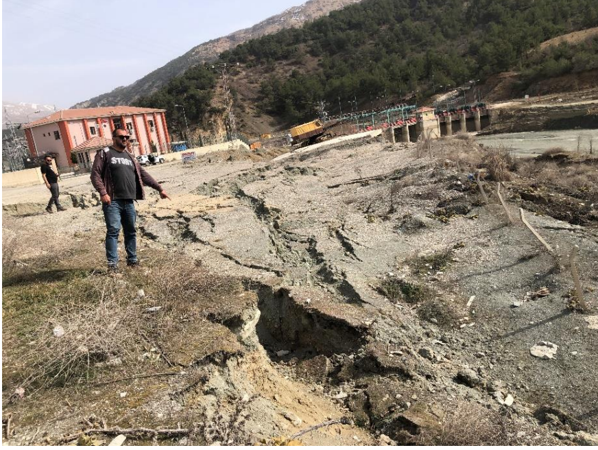
Şekil 39. Nurhak Karayolu üzerinde deprem sırasında meydana gelen zemin sıvılaşması ile gelişen yanal yayılma ve dairesel kayma türünde yenilmeler karayolu boyunca mevcut şevlik kesimlerdeki mühendislik yapılarına önemli ölçüde zarar vermiştir.
