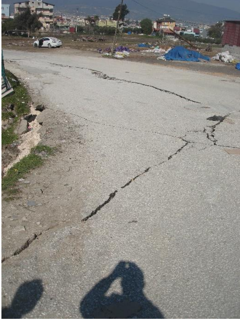
Şekil 26. Hatay il merkezi 3-4 km güneyi Tepehan yolu üzerinde sıvılaşma nedeniyle meydana gelen deformasyonlar.
