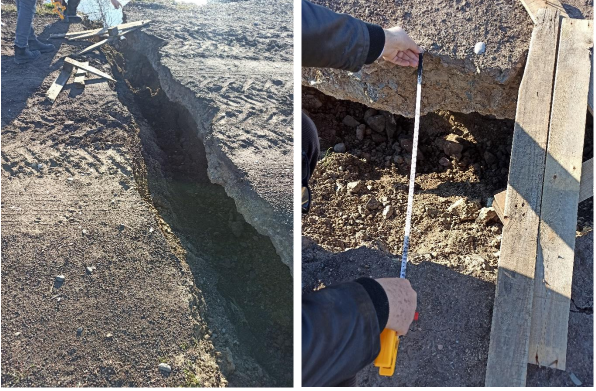
Şekil 35. Beyoğlu, Yeni Mahalle civarında (Kahramanmaraş) DAF zonu üzerinde yaklaşık Dere üzerindeki köprü kenarında köprü'nün bentleşmesi nedeniyle güney kenarında 50 cm lik açılma.
